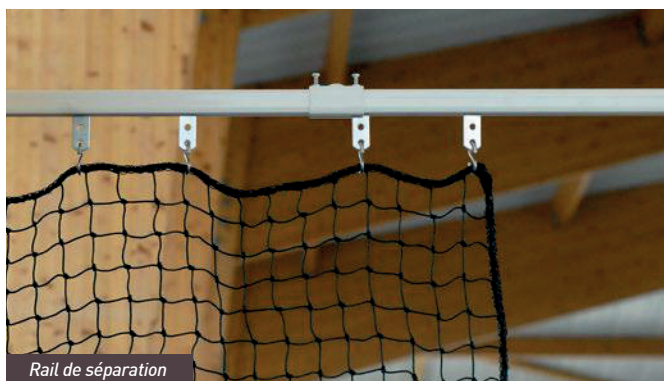
Rail de séparation
